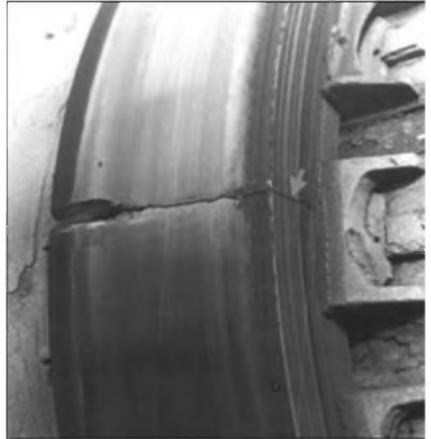
Типичное разрушение бандажа вращающейся печи в результате образования сквозной поперечной трещины
